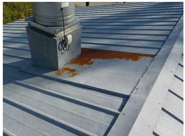
Ruostejälkiä huippuimurin vierellä
