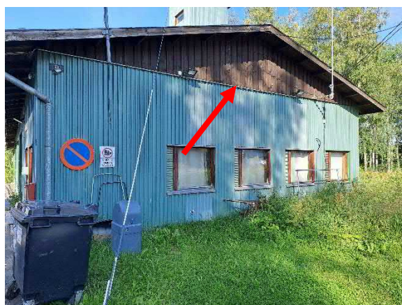
Kulkuluukku yläpohjaan, johon ei ole tikkaita
