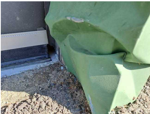
Nosto-ovien vierellä pellityksessä vaurioita
