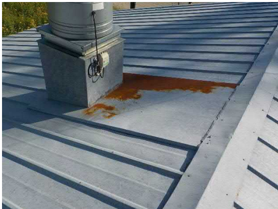
Kiinteistön sosiaalitilojen poistoilmahuippuimuri.
