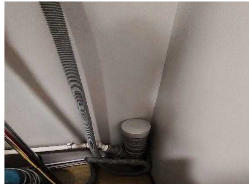
Alkuperäinen muovinen tuuletusviemäri ja alipaineventtiili.
