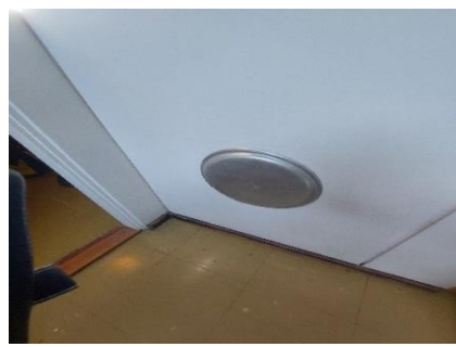
Täysin kiinni oleva korvausilmaventtiili.
