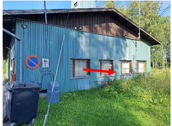
Tuuletusteline rakennuksen päädyssä
