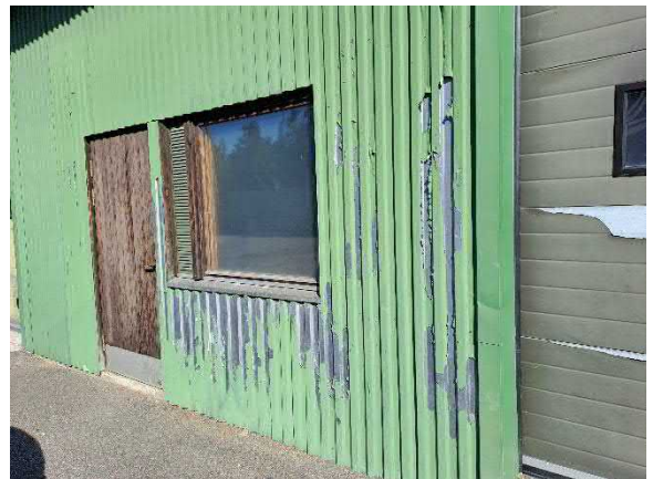
Työpajan julkisivujen profiilipelleissä pinnoitevaurioita
