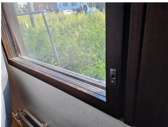
Koulutustilan ikkunan sisäpuutteessa maalipinnan vaurioita
