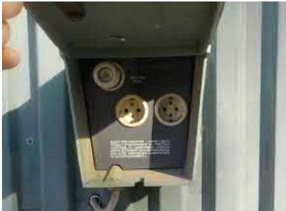
Ajoneuvon lämmityskotelo ulkoseinällä
