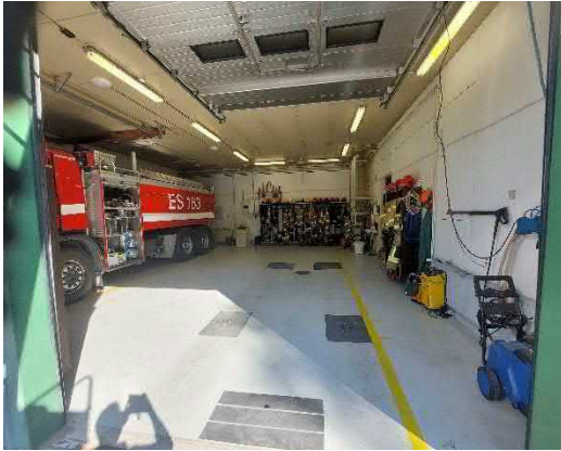
Kalustohallissa painovoimainen ilmanvaihto.
