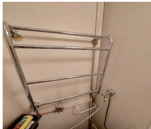
Siivouskomeron käyttövesipatteri ja puutteelliset venttiilit.
