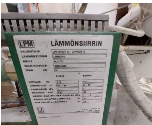
Alkuperäinen lämmitysverkoston lämmönsiirrin, tekninen käyttöikä ylittynyt.
