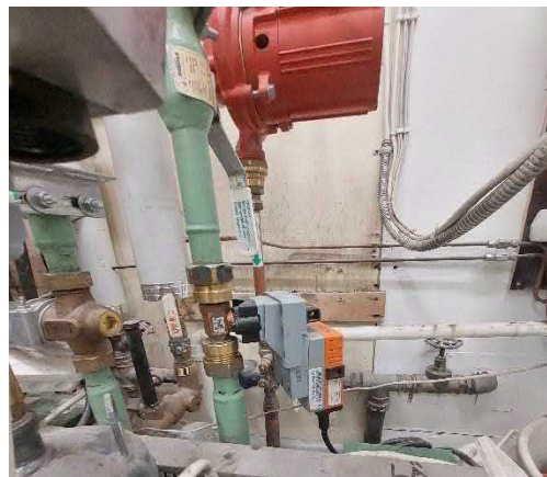
Vuonna 2018 uusitut säätöventtiilit.
