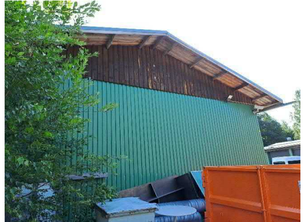
Länsipäädyn puuosissa vaurioita/maalipinnan kulumaa
