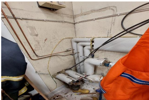
Kaukolämpöjohdoista puuttuu osa eristeistä ja läpiviennit ovat puutteelliset.
