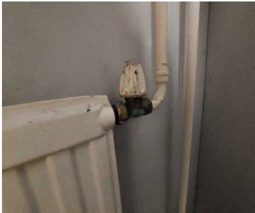
Alkuperäinen patteriventtiili, tekninen käyttöikä ylittynyt.
