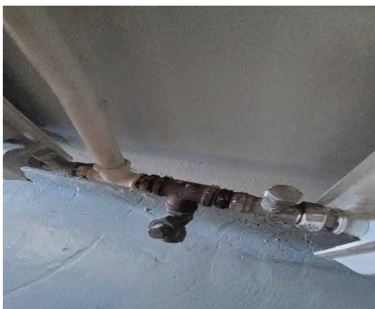
Ruostetta patterin kytkentäputkessa.
