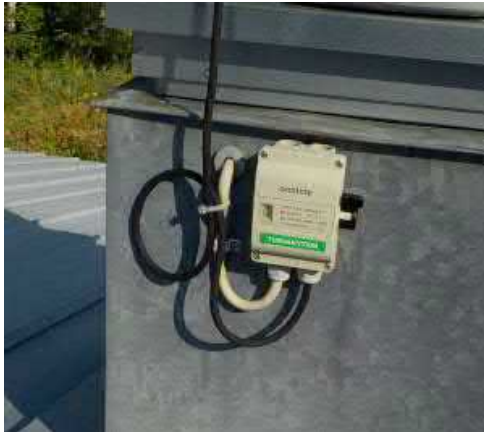
IV-koneen läpivienti vesikatolla
